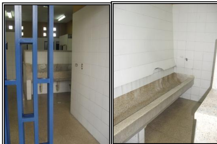
ILUSTRACIÓN 21 PUERTAS DE ACCESO EN REJA – ENCHAPE DE ORINALES DETERIORADO
