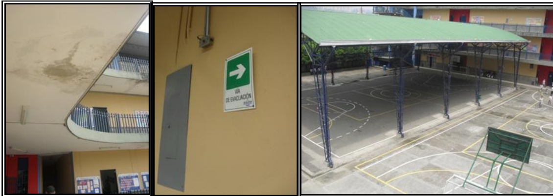
ILUSTRACIÓN 26 MUROS Y TECHOS DETERIORADOS POR HUMEDAD – SEÑALIZACIÓN DE EVACUACIÓN – CANCHA EN LOSA DE CEMENTO
