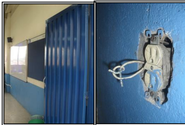
ILUSTRACIÓN 20 PUERTAS EN BUEN ESTADO – TÓMAS E INTERRUPTORES EN MAL ESTADO
